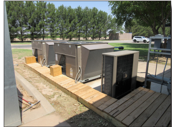
New HVAC Units @ DES
