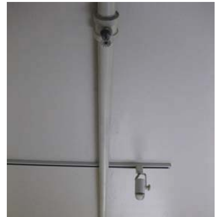
Sprinkler system- Padre Martinez
