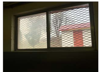
Replace exterior windows
