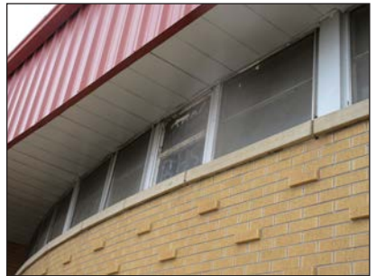
Replace exterior windows
