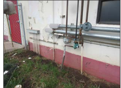
Evaluate all conduit lines & remove all unused conduit
