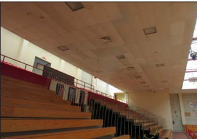
Replace wood bleachers
